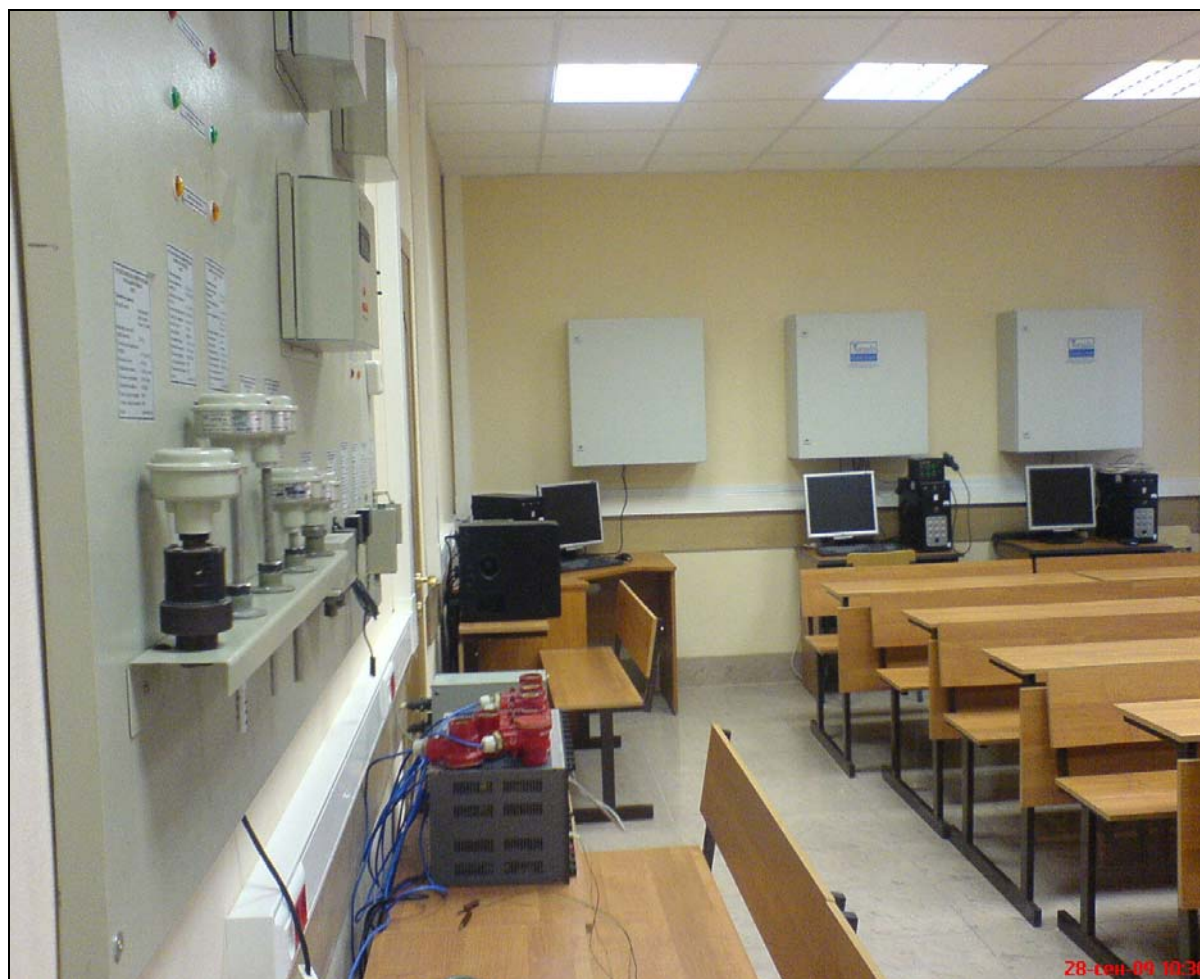
Рис. 6. Размещение технических средств ПТОК в помещении учебной аудитории
