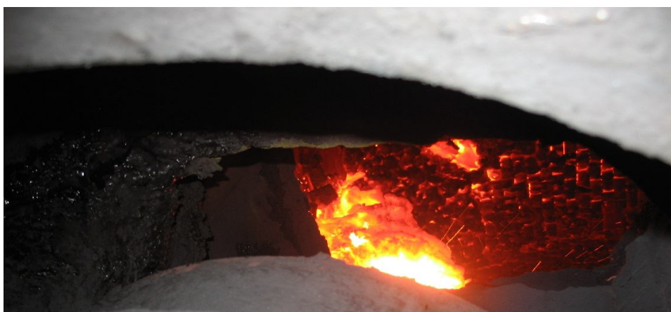
Рис. 3. Горение битумных отложений после остановки печи
