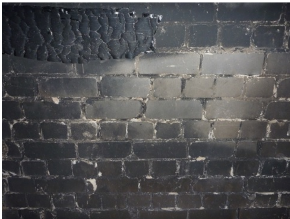
Рис. 1. Общий вид стены здания после пожара
