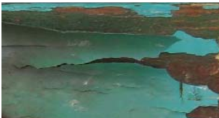
Рис. 1. Частичное отслоение пленки лакокрасочного материала от поверхности элемента деревянной конструкции
