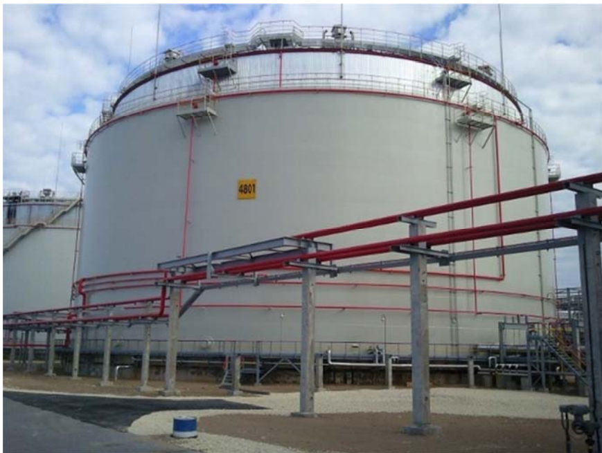
Рисунок 2. Пример действующего резервуара с защитной стенкой
