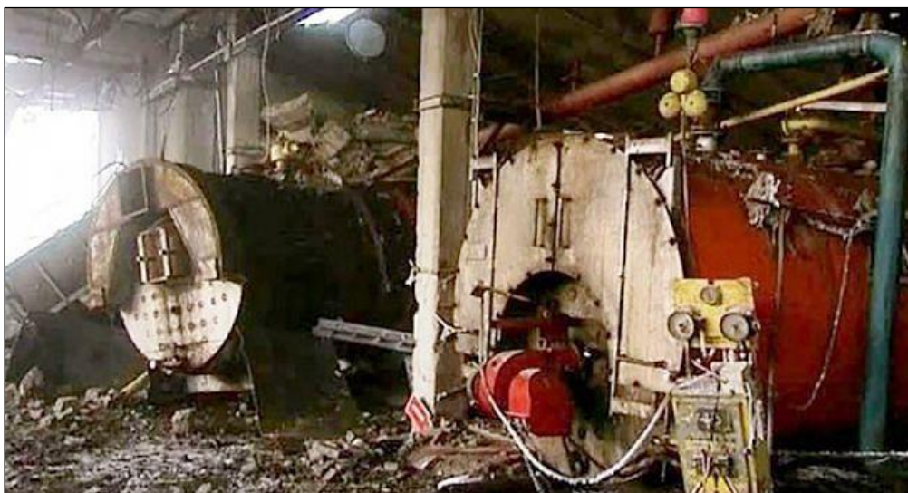
Рис. 3. Последствия взрыва на ОАО "ИВХИМПРОМ" [3]
